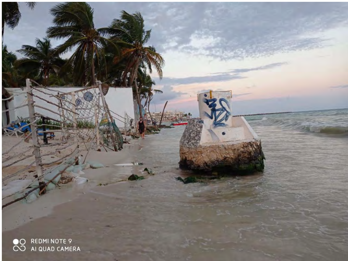
Figura 3.20 Socavación de cimientos, cárcamo de la Comisión de Agua Potable y Alcantarillado afectado por el oleaje, enero 2020
