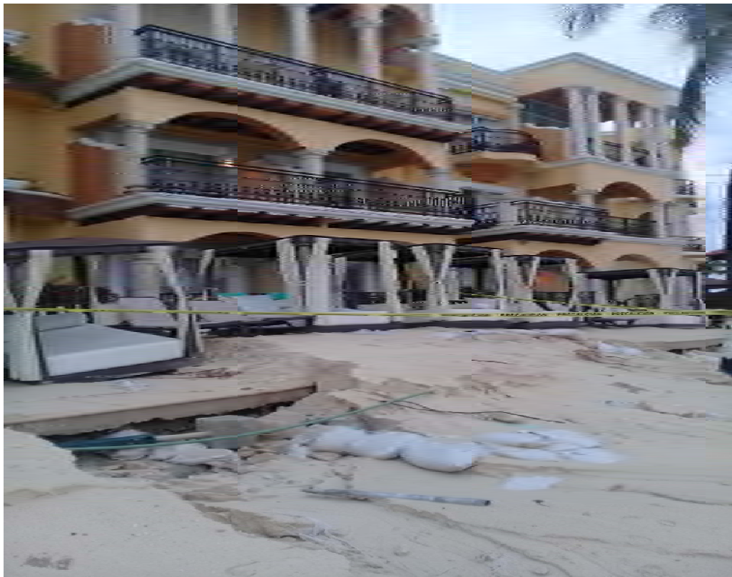
Figura 3.18 Socavación y desestabilización de los cimientos por erosión costera, enero 2019
