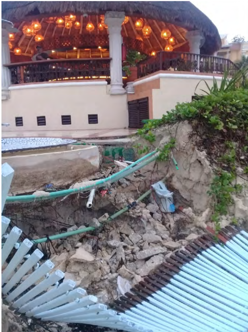
Figura 3.19 Daños a infraestructura del hotel porto real, junio 2020
